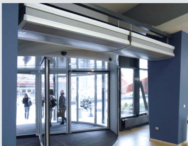
Installazione a vista
